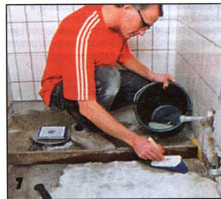
Раствор, образующий новое основание пола, укладывали на старую увлажнённую плитку. Важно хорошо увлажнить основу, чтобы сцепление раствора с ней было прочным.
