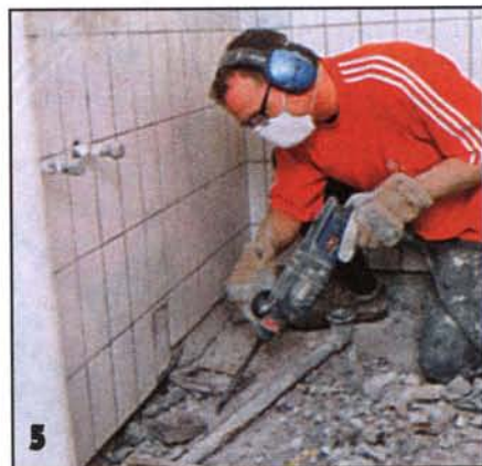
Водопроводные и сливные трубы, вмонтированные в пол, тоже должны быть заменены. Некоторые из них сильно проржавели и могли в любой момент потечь. Чтобы в этом убедиться, достаточно постучать по ним молотком — они мнутся и не издают характерного металлического звука.
