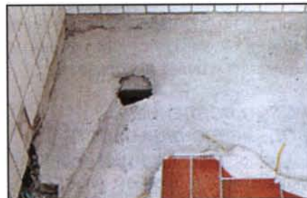
Вот так выглядит сверху пол ванной после удаления подводящих и сливных труб. Часть клинкерного покрытия осталась нетронутой. Электроподогрев пола не работает, так как кабель порван.
